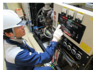
非常用予備発電装置試験
