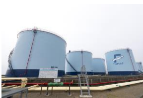
オイルターミナル
