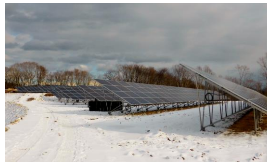
施工事例 平成27年1月竣工の産業用太陽光発電設備 (函館地区：設置容量806kW)
