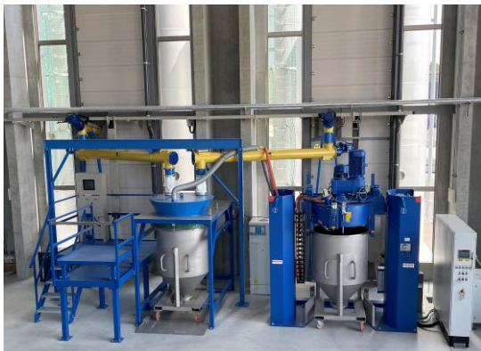
自己治癒コンクリート Basilisk 製造設備
